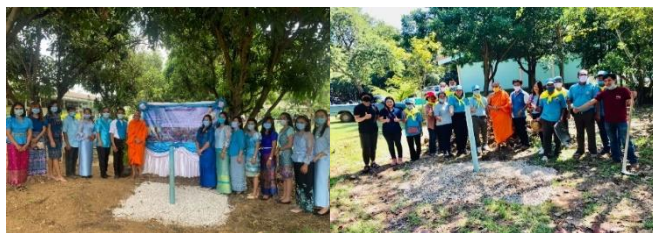
ภาพที่ 3 ต้นแบบธนาคารน้ำใต้ดิน (ระบบปิด) โรงเรียนบ้านคลองไถ่เถื่อน จำนวน 10 จุด และวัดคลองไถ่เถื่อน จำนวน 3 จุด เบื้องต้นสามารถแก้ไขปัญหา น้ำท่วมขังได้เป็นอย่างดี น้ำใต้ดินเพื่อชุมชน
